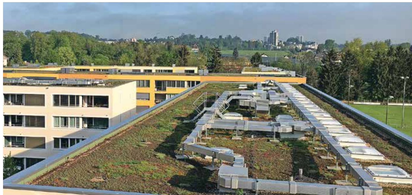
Immer mehr Drittinstalltionen auf den Flachdächern erhöhen das Risiko eines Wasserschadens.
